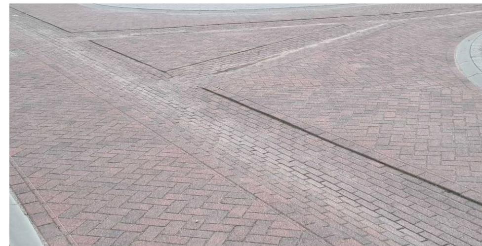
Kolkloos parkeerterrein, regenwater stroomt af naar groenzones, en indien nodig naar infiltratiekratten
