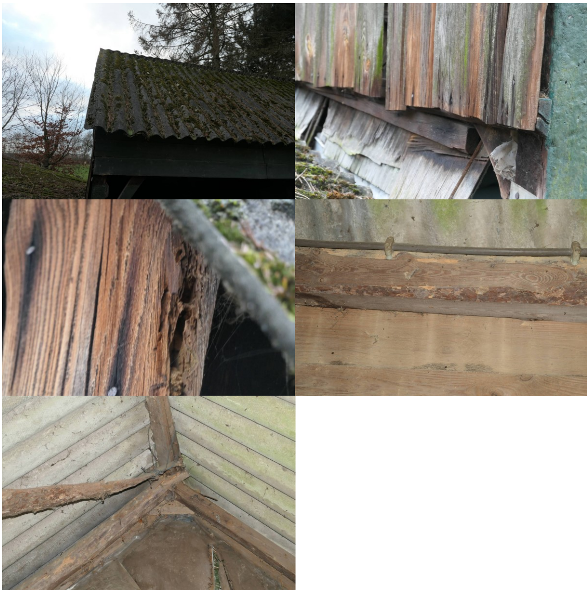
Figuur 21: detailfoto's te slopen schuren
