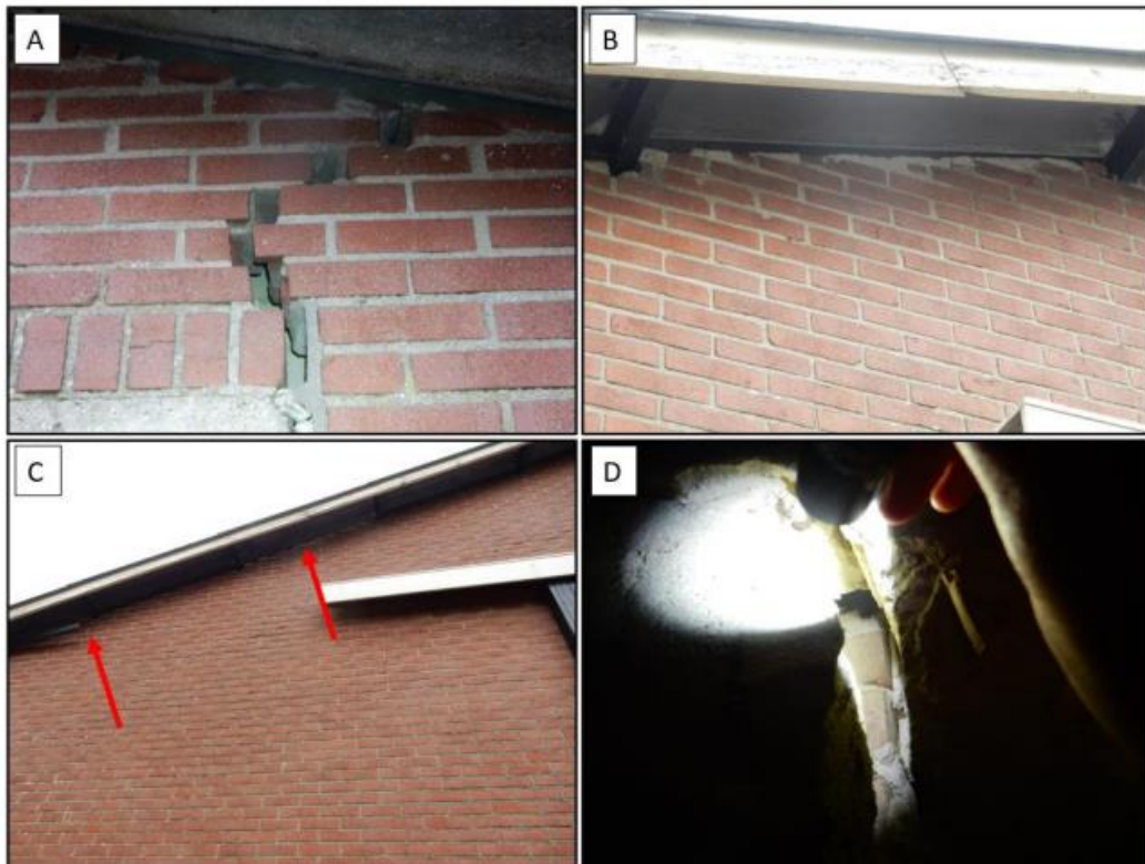
Figuur 1.3 Potentiële invliegopeningen voor vleermuizen aan de zuidzijde van de ligboxenstal. (A) een scheur in de muur vormt een potentiële invliegopening. (B) een deel van de muur waar de houten aftimmering ontbreekt. (C) de rode pijl wijst enkele plekken aan waar de houten aftimmering ontbreekt of deels loshangt. (D) vanuit de binnenzijde van de ligboxenstal is goed zichtbaar dat er een open spouw aanwezig is. Deze foto is gemaakt aan de binnenzijde van de scheur die afgebeeld is op foto A.
