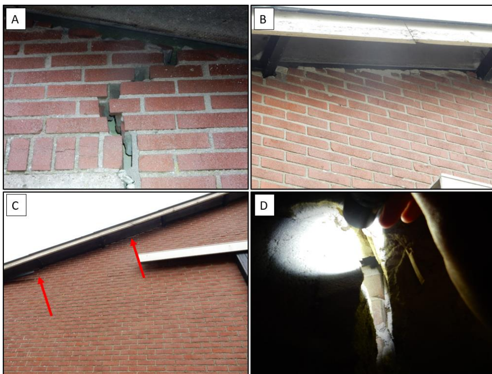
Figuur 4 Potentiële invliegopeningen voor vleermuizen aan de zuidzijde van de ligboxenstal. (A) een scheur in de muur vormt een potentiële invliegopening. (B) een deel van de muur waar de houten aftimmering ontbreekt. (C) de rode pijl wijst enkele plekken aan waar de houten aftimmering ontbreekt of deels loshangt. (D) vanuit de binnenzijde van de ligboxenstal is goed zichtbaar dat er een open spouw aanwezig is. Deze foto is gemaakt aan de binnenzijde van de scheur die afgebeeld is op foto A.
