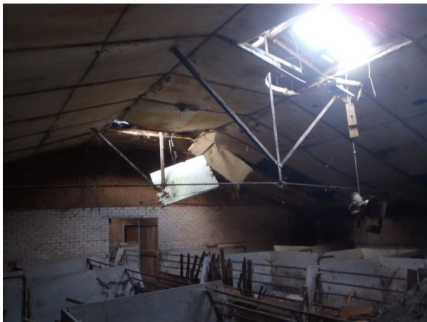
Foto 3: interieur van de varkensstal. De deels doorhangende en missende isolatieplaten, het kapotte dak en de oorspronkelijke stalinrichting zijn zichtbaar.
