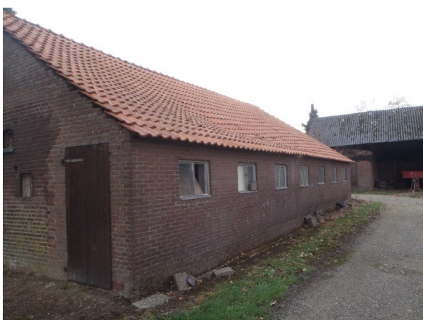
Foto 9: links de oude veestalling met het doorgezakte pannen dak. Op de achtergrond de kapschuur.
