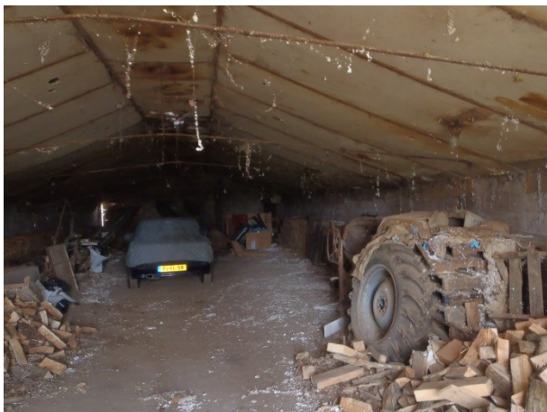
Foto 8: het interieur van de aardappelberging. Op de foto zijn de restanten van de kapot gebeten polystyreenplaten zichtbaar. Rechtsachter, nog juist zichtbaar, de stobalen die als extra isolatie zijn gebruikt.
