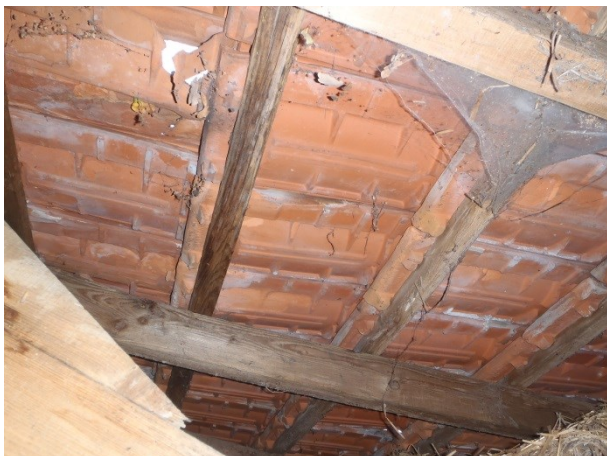
Foto 10: het pannendak van de veestalling gezien door een kleine kier in het plafond. Onder de pannen is geen dakbeschot aanwezig.
