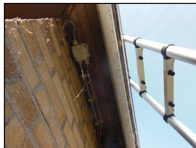
Figuur 7. Aanwezige elektra bij hoofdgebouw. Rondom de openingen is isolatie aangebracht.
