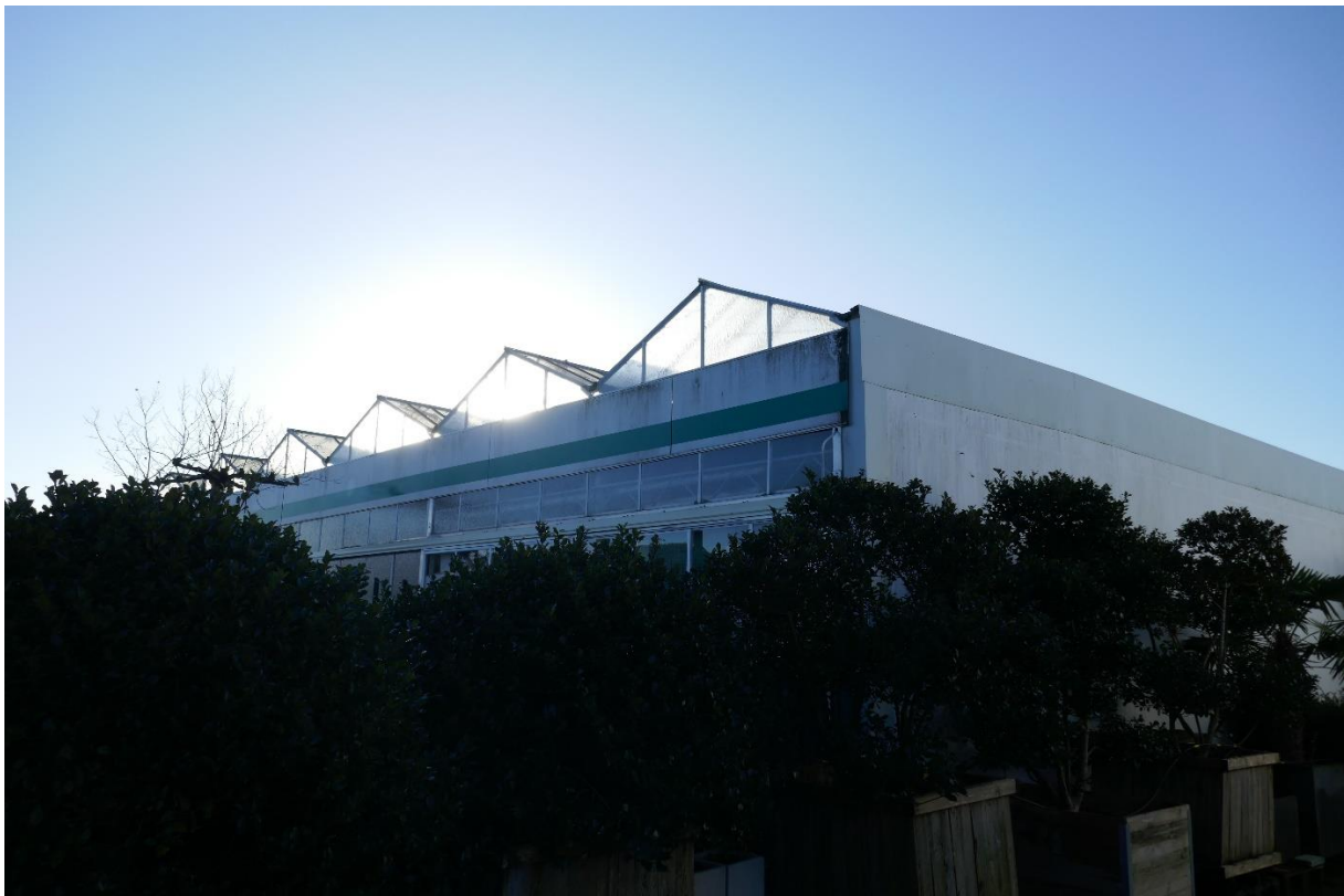
Foto 2: De dakconstructie is geheel ongeschikt voor soorten als huismus, gierzwaluw en andere gebouwbewonende broedvogels (al of niet met jaarrond beschermde nesten)
