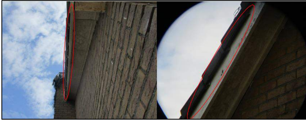
Figuur 3 Kierende kantpannen aan de kopgevels van het woonhuis.
