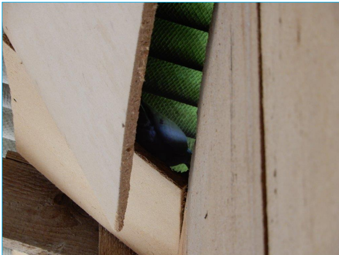
Foto: Verborgen duivennest achter isolatiepanelen.
