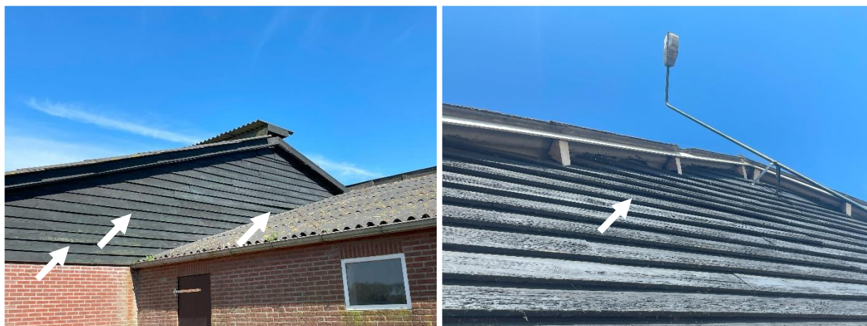
Potentiële invliegopeningen in de houten topgevel van de te slopen bebouwing, aangeduid met witte pijl.
