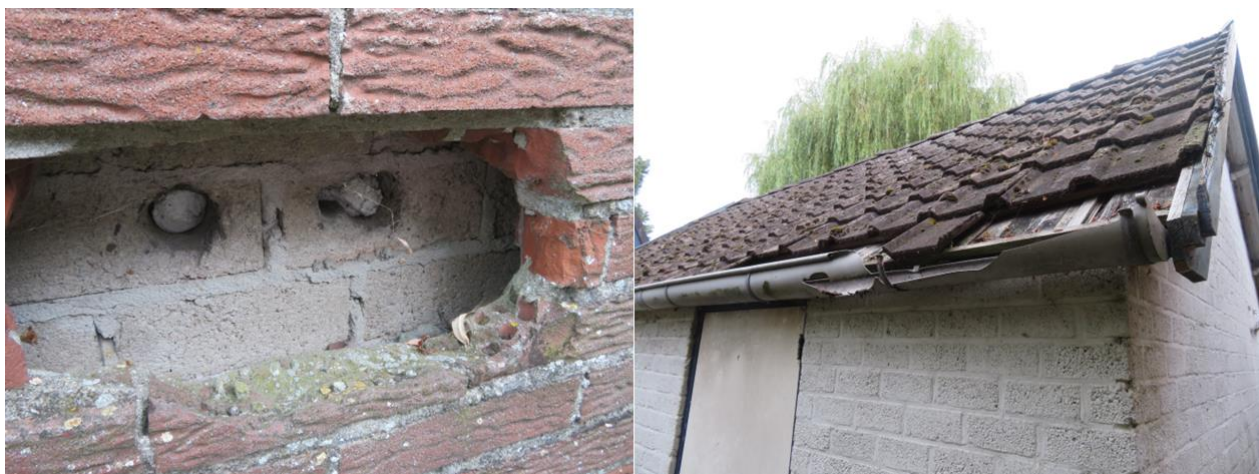
Afbeelding 16 en 17: Zichtbare smalle spouw, welke alleen toegankelijk is via deze opening op circa 2 meter hoogte. Er zitten geen open stootvoegen in het gebouw. De foto ernaast geeft aan dat er een paar pannen ontbreken op het schuurtje. De pannen sluiten direct aan op de schrootjes (zie afbeelding 7).
