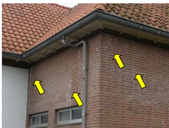
Figuur 4.1 Krijtsporen (bij gele pijlen), pannendak en dakgoot.
