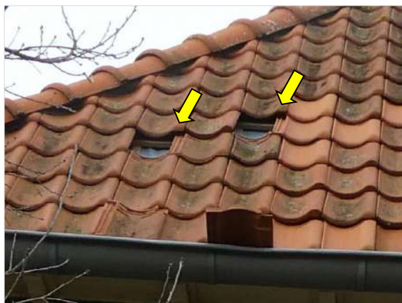
Figuur 4.3 Openingen onder de dakpannen (bij gele pijlen).
