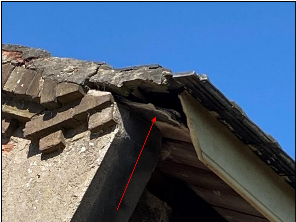
De woning bevat (kapotte) golvende dakpannen en veel kieren en openingen (zie rode pijl) die groot genoeg zijn voor de gierzwaluw om onder het dak te kruipen.
