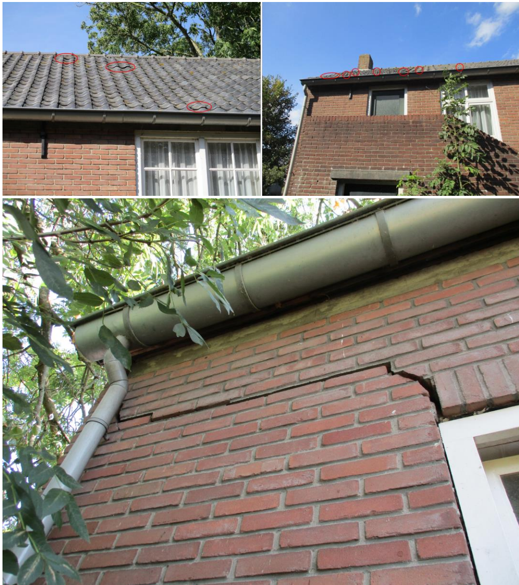
Figuur 2 In de bebouwing zijn enkele openingen onder dakpannen en in de muren waargenomen waar vleermuizen mogelijk gebruik van kunnen maken. Tevens zijn er een aantal kierende kantpannen aanwezig, waardoor aanwezigheid van vaste rust- en verblijfplaatsen niet uitgesloten kunnen worden
