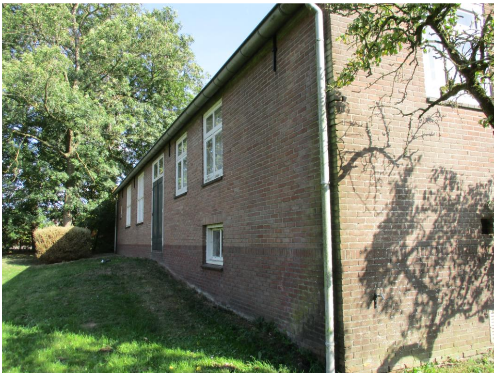
Figuur 2 Aan de achterzijde is een grote scheur in de muur aanwezig en enkele opstaande dakpannen, waardoor de vaste rust- en verblijfplaatsen niet uitgesloten kunnen worden.
