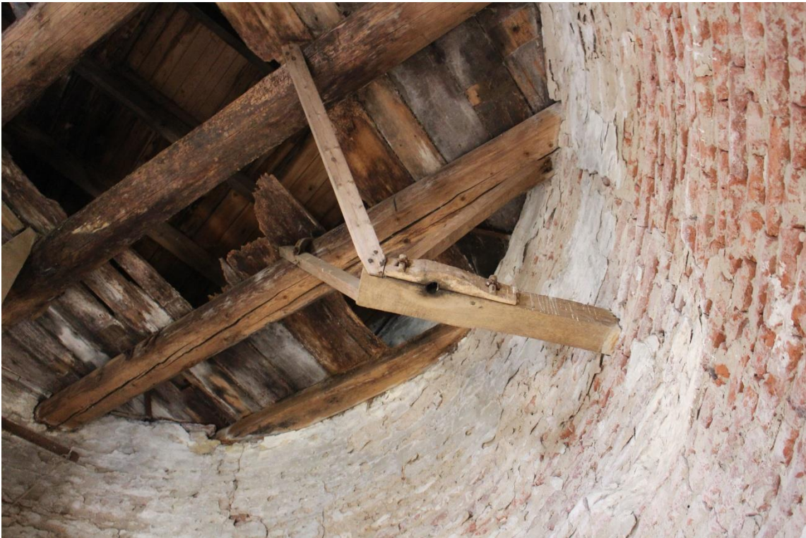
Lageringsbalkje waar waarschijnlijk een reguleur in heeft gedraaid. Dit onderdeel dient behouden te blijven.
