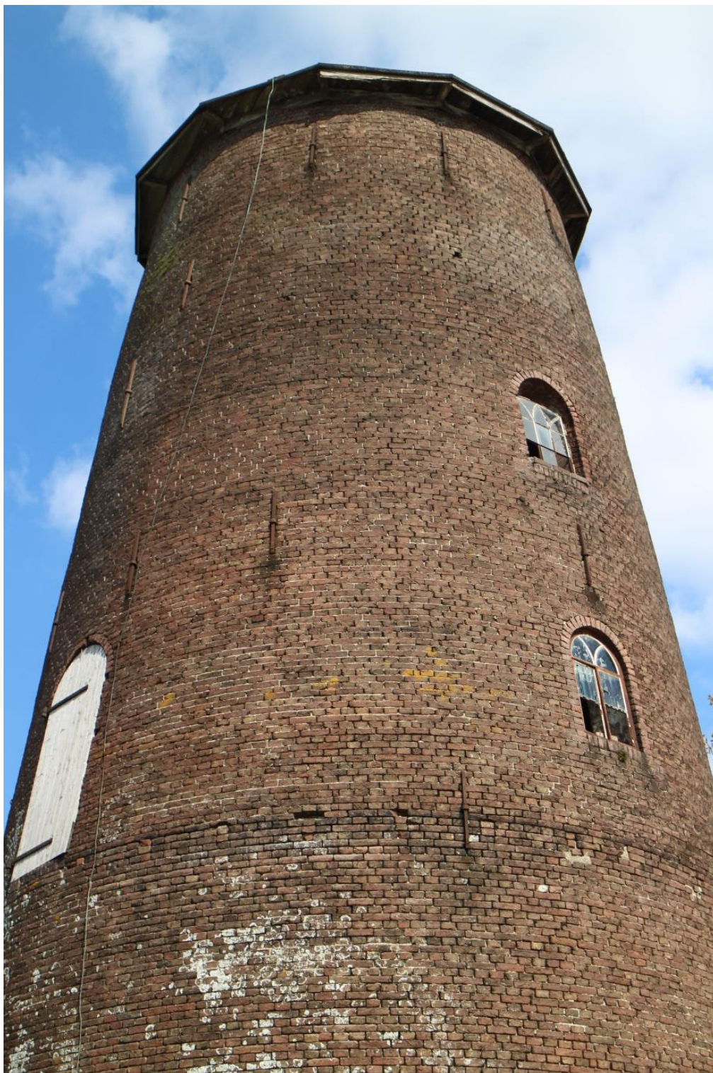
Bovenzijde van de romp. Bij diverse balken zijn muurankers aangebracht.
