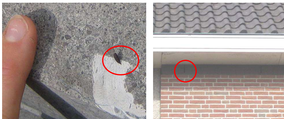
Aangetroffen keutel (links) en toegang tot spouwmuur (rechts) in de uitbreiding (foto's SAB Arnhem B.V.)
