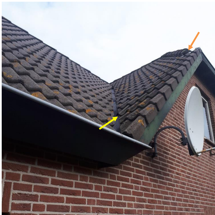
Figuur 8. Potentieel geschikte nestplaatsen voor de huismus onder de nokvorst (oranje pijl) en onder dakpannen langs de kilgoot (gele pijl).
