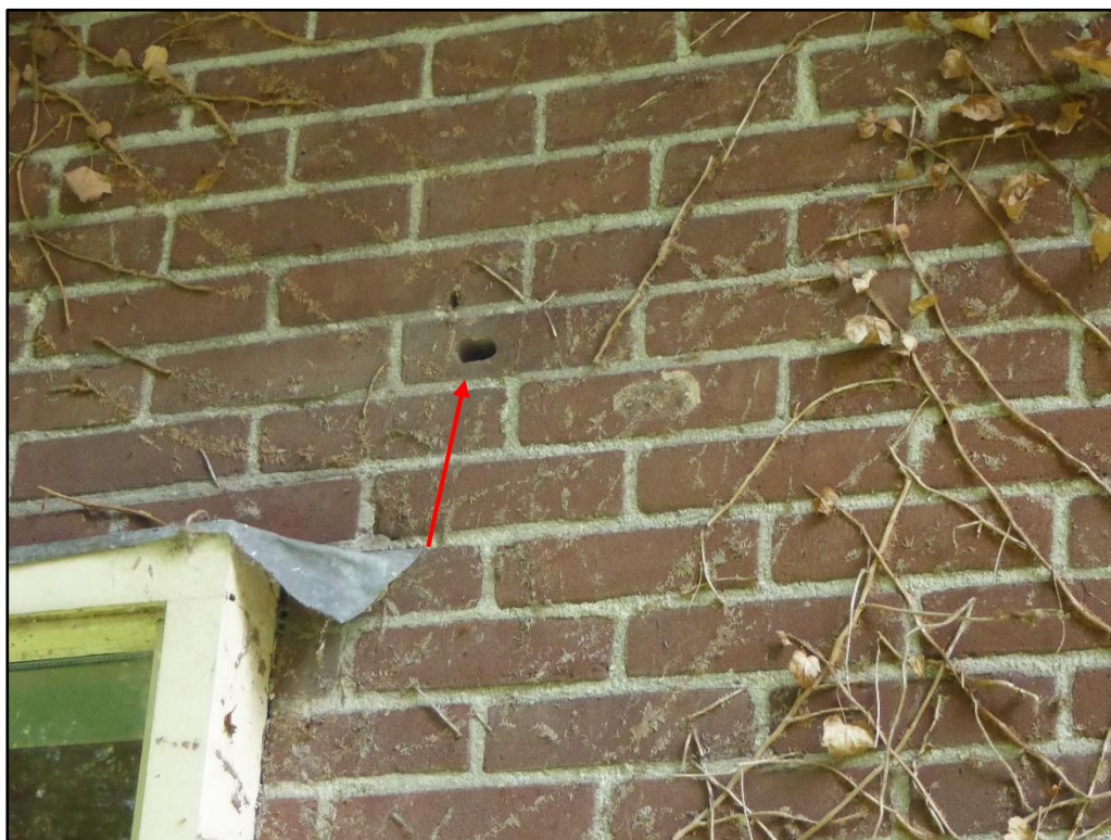
Voorbeeld van een gat in de muur van de woning, waardoor vleermuizen de spouwmuur kunnen bereiken.
