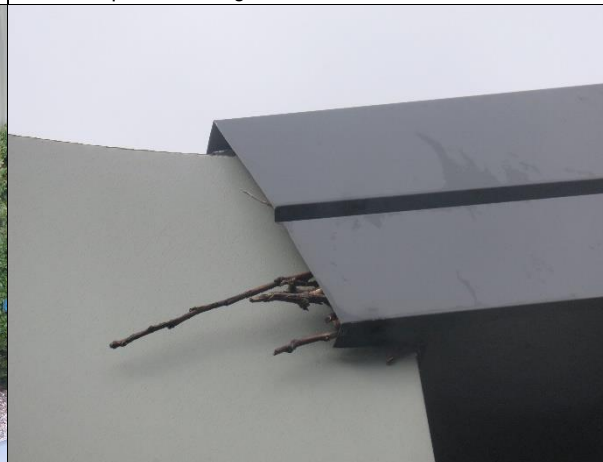
Foto 6: Takken in dakgoot
