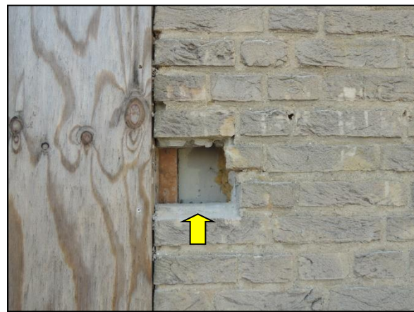
Figuur 11. Gaten bieden toegangsmogelijkheden tot de spouwmuur.
