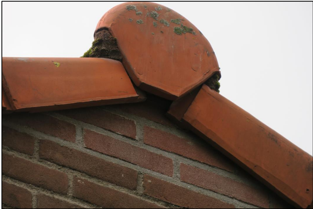
Figuur 4 In de bebouwing zijn openingen aangetroffen welke leiden naar mogelijk geschikte nestlocaties van huismus en gierzwaluw en verblijfplaatsen van vleermuizen.
