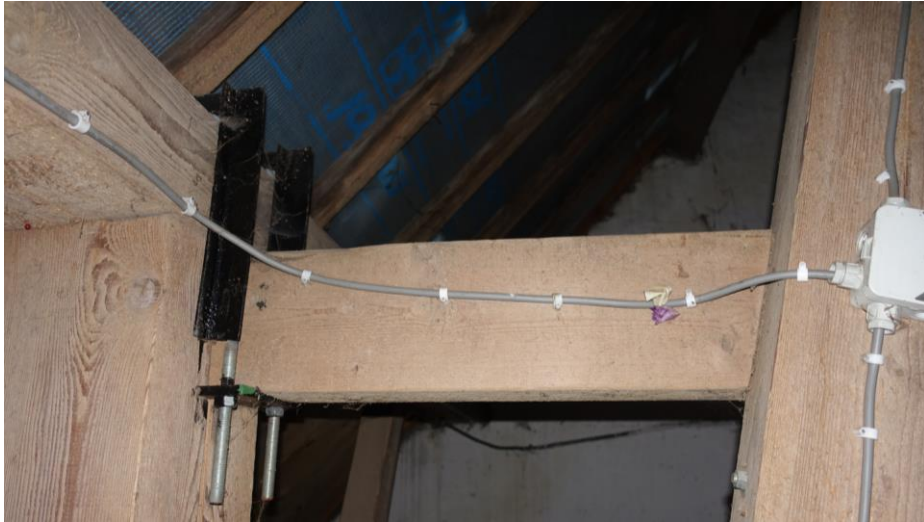
Detail van de recent aangebrachte beugel bij de verbinding tussen de blokkeel en de gebintstijl.
