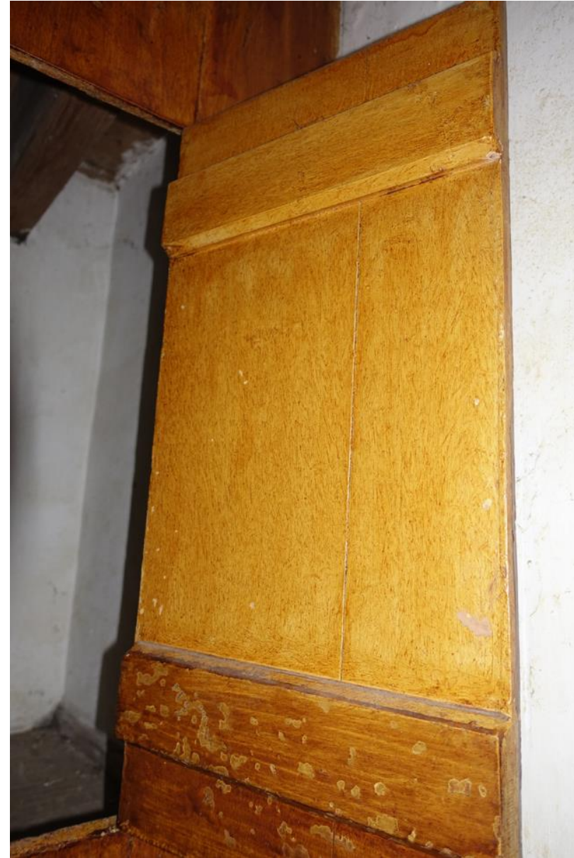
De wand van de trap naar de verdieping aan de zijde van de inbouwkast is voorzien van bergruimte. De houten wanden en deurtjes hiervan zijn voorzien van een houtimitatie.
