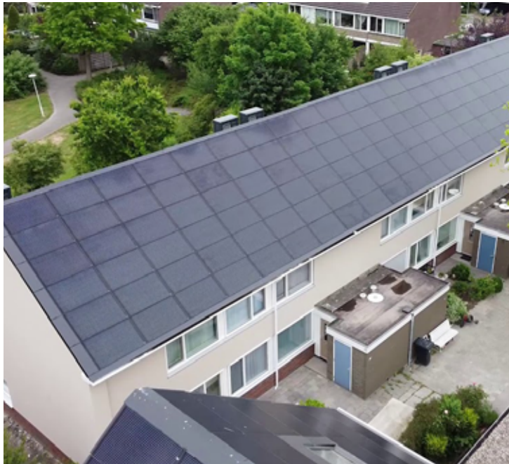
PV panelen beslaan het gehele dakvlak
