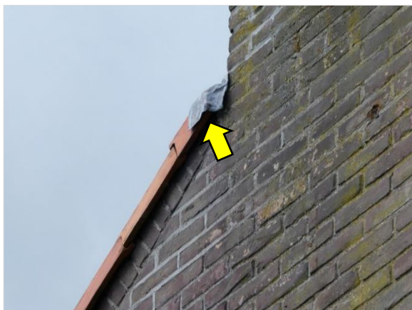
Figuur 4.7 Opening onder loodslab bij schoorsteen.
