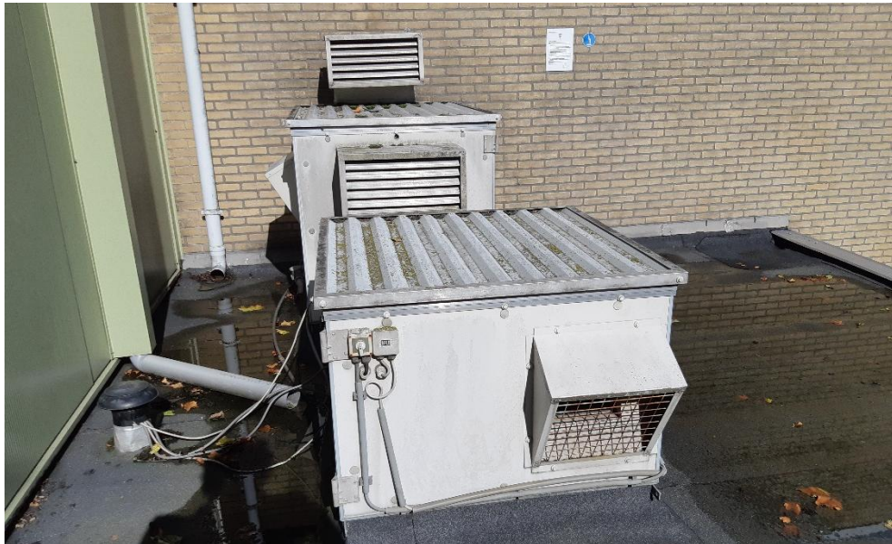
Luchtbehandelingsinstallaties / ventilatie aan zuidzijde sporthal
