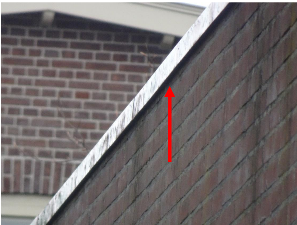
Geschikte kieren tussen de daktrim en de gevels.
