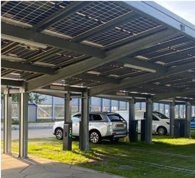
Laadpalen gemonteerd nabij of tussen de staanders.
