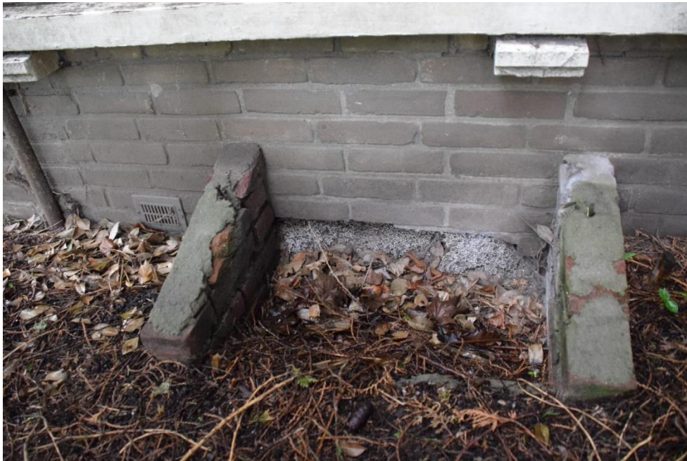
17 Oud kelderluik met een grote toegang tot de spouwmuur en de kruipruimte, hoewel deze geblokkeerd is door isolatiemateriaal.
