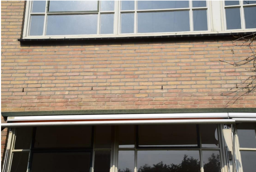
3 Open stootvoegen op de gevel van het schoolgebouw.
