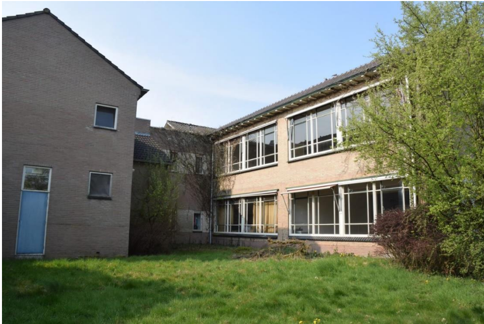
5 Een van de kopse gevels met kantpannen. In de hoek van het gebouw is één van de grote, dode, klimop-planten aanwezig die zich onder de overstek, kantpannen en door het ventilatierooster heen heeft gwerkt. Op het dak zitten nog twee houtduiven.
