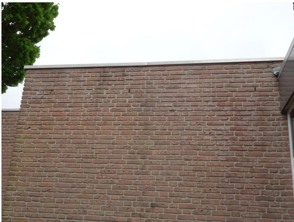
Voorbeeld van de aanwezige open stootvoegen in de gevels van het bibliotheekgebouw.
