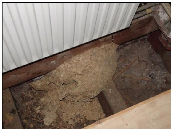
Figuur 13. Loze ruimte onder de vloer waar zich eerder een wespennest heeft gevestigd.
