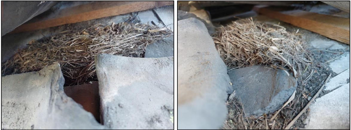
Figuur 2 Aan de noordzijde van het dak is een zeer oud zangvogelnest aangetroffen onder de dakpannen. Er ontbreekt een komvorming en het materiaal is circa 7 cm in doorsnede. Hierdoor is niet meer te bepalen aan welke vogelsoort het toegekend kan worden.
