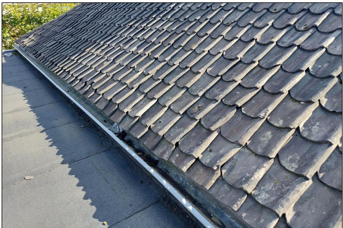
Figuur 2 Het dak aan de noordzijde waar een oud vogelnest is aangetroffen.
