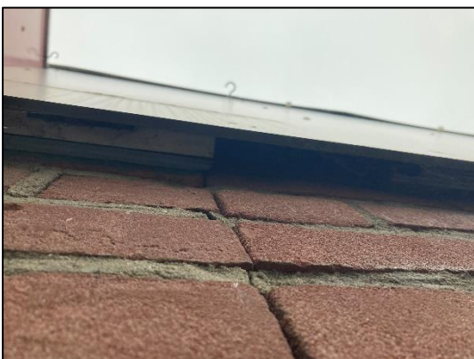
Figuur 6.3: Kieren tussen de gemetselde muur en de HPL-platen.
