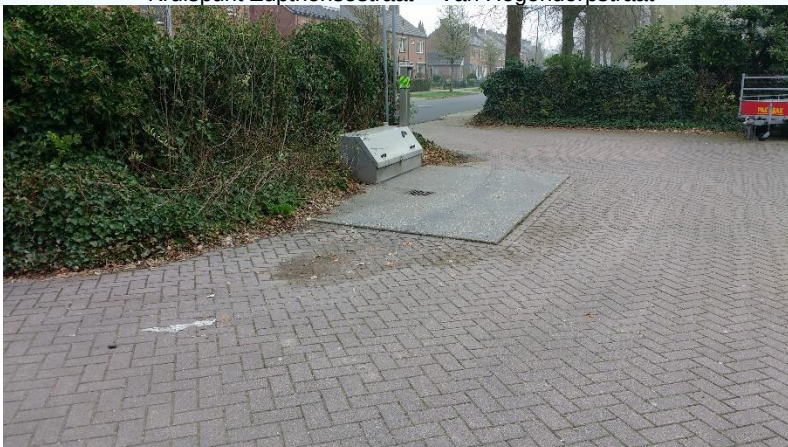
Tankontluchting, dampretour en vulpunt
