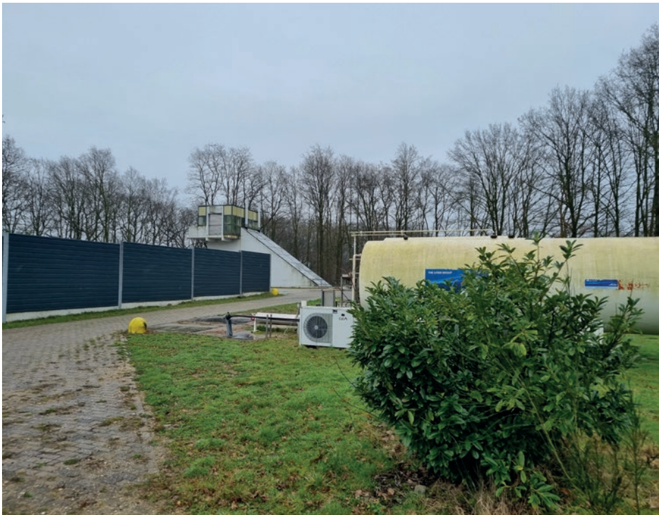
4 terrein met waterzuiveringsinstallatie
