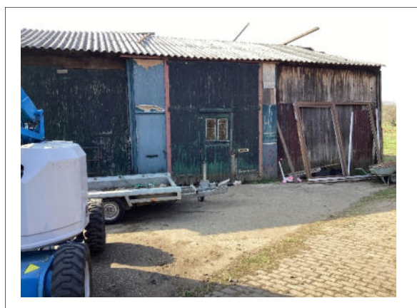
Gesloten verharding onder asbestdak
