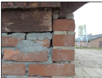
Figuur 16. Enkelsteens muren met ruimte tussen de voegen.
