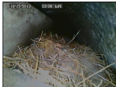
Figuur 11. Nestrest huismus onder golfplaten dak.
