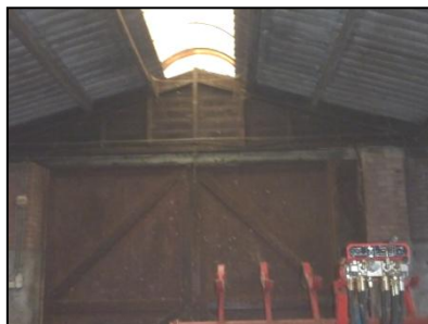
Figuur 17. Achter gevelbetimmering aan de nok is geen besloten ruimte.
