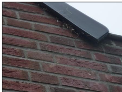
Figuur 10. Nest spreekw onder dakpan.
