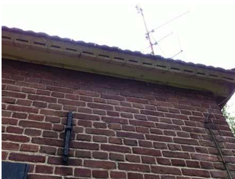
Mogelijke toegangsplekken tot holle ruimte onder het dakvlak. Mogelijk in gebruik bij vleermuizen als verblijfplaats.
