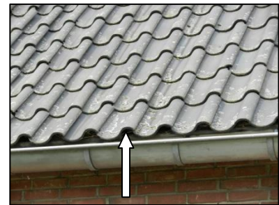
Figuur 11: Nesten onder dakpannen aan de Windheuvelstraat nummer 17.
