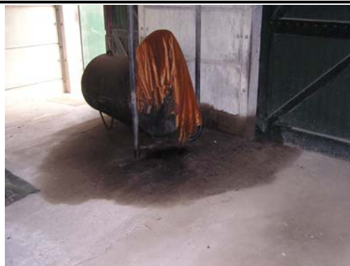
Foto b6.6 Bovengrondse tank
