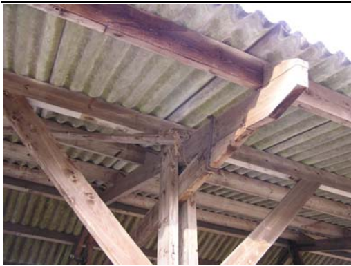
Foto b6.3 Dakbedekking mogelijk asbest
