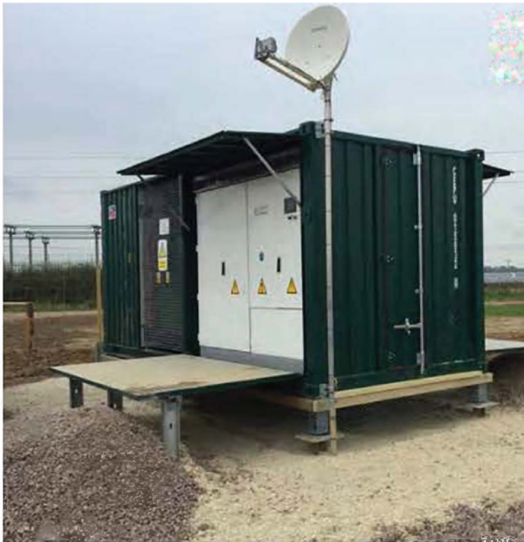
Referentie beeld transformator en omvormerstation
