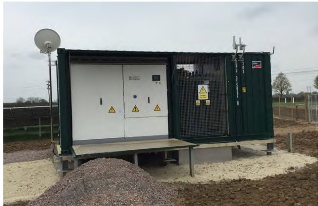
Referentie beeld transformator en omvormerstation
