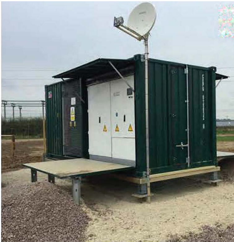
Referentie beeld transformator en omvormerstation
