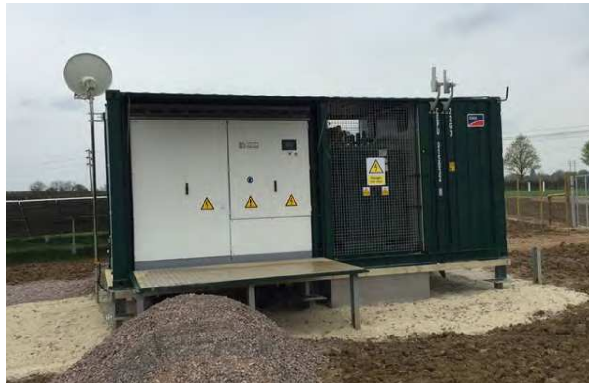
Referentie beeld transformator en omvormerstation
