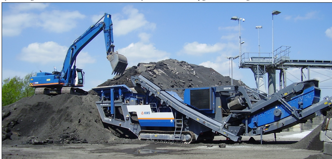
Afbeelding 1- Overzicht van de breek- en zeefinstallatie zoals opgesteld te Hoogblokland.
