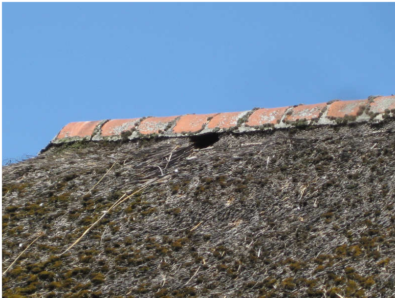
Figuur 5: gat in het dak, waarschijnlijk door kauwen gemaakt.
