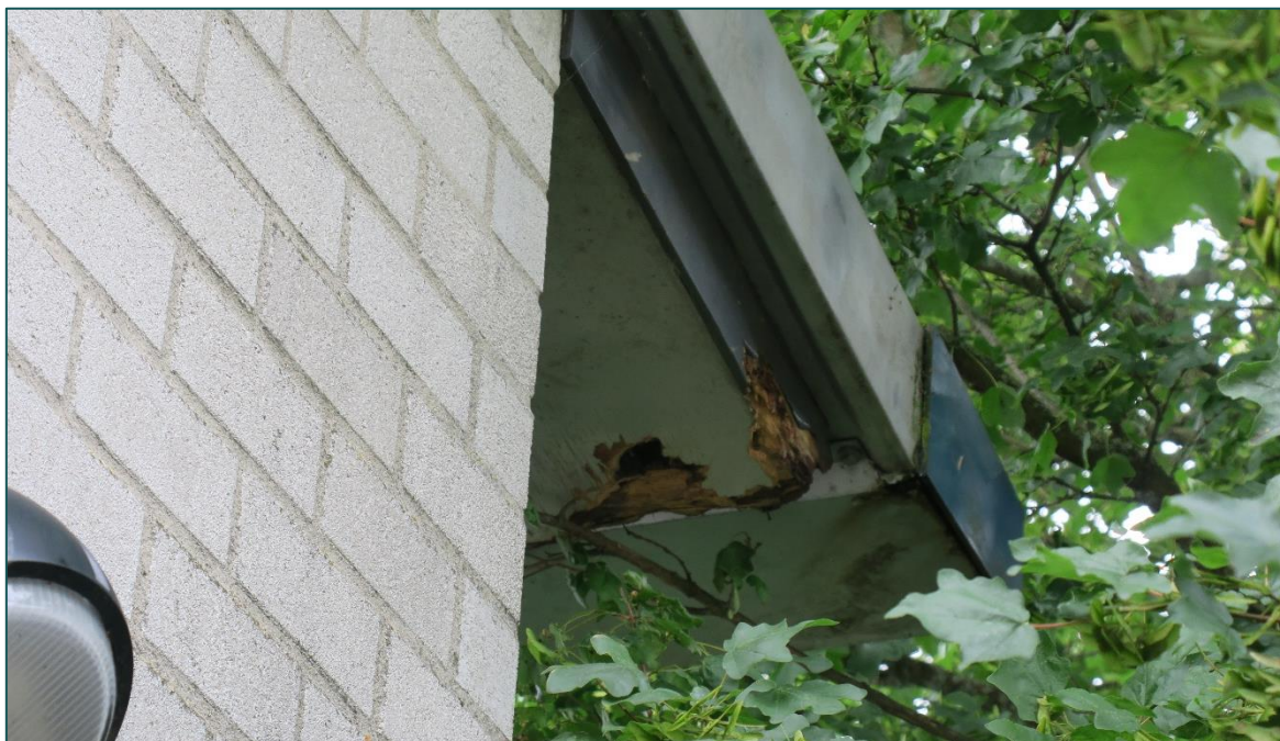
Figuur 3.1 Opening in dakoverstek in het pand aan de Wilhelminalaan 43.
