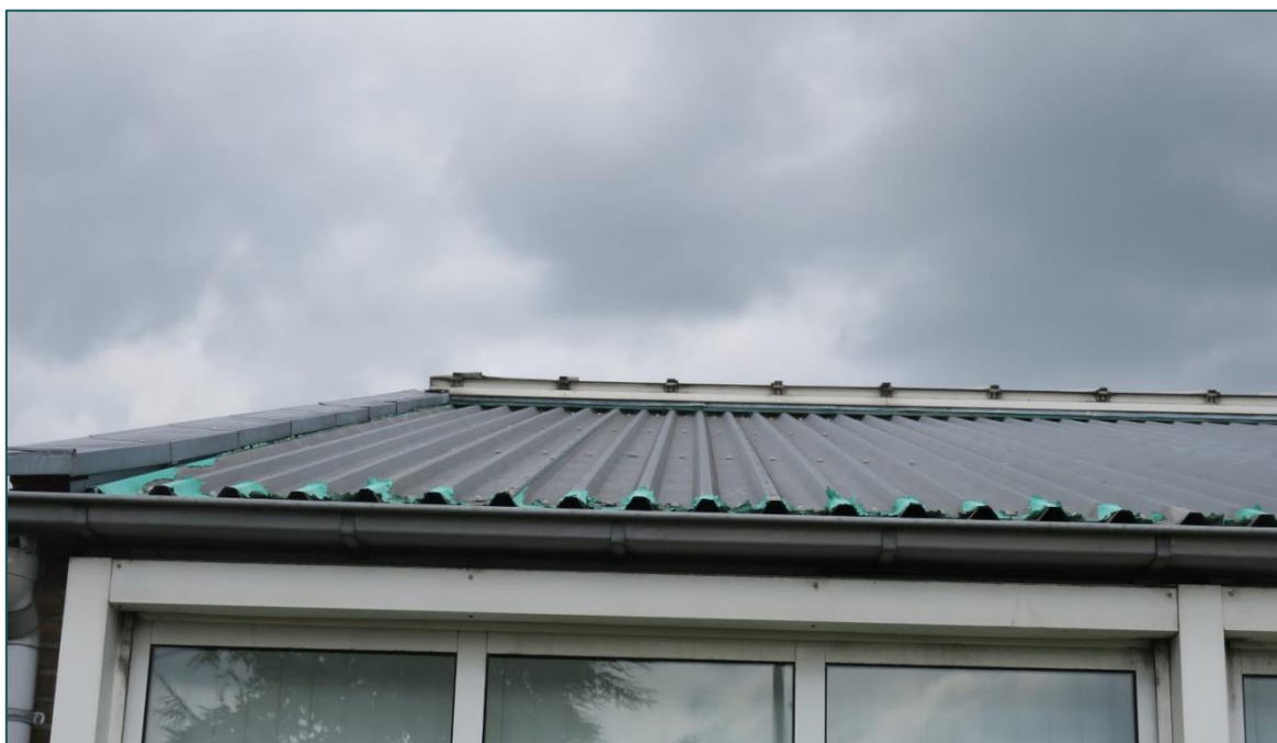
Figuur 3.3 Openingen onder metalen golfplaten aan de Wilhelminalaan 45
