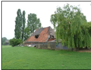
Figuur 4. De vervallen schuur.
