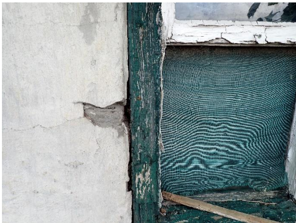
Foto 9: Links, rondom de kozijnen zijn meerdere kieren aangetroffen.
