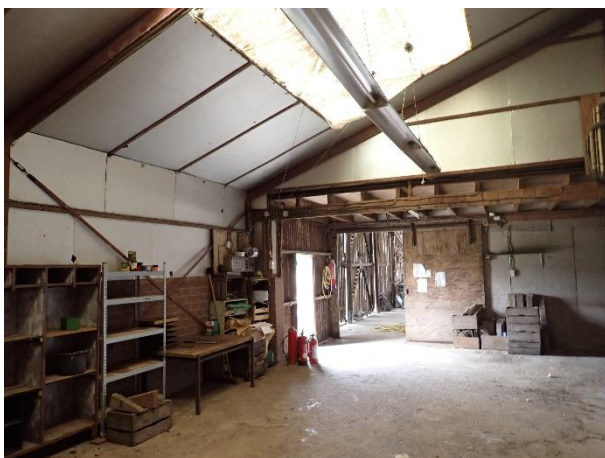
Foto 25: Links, de openstaande deur gaat richting gebouw 4.
