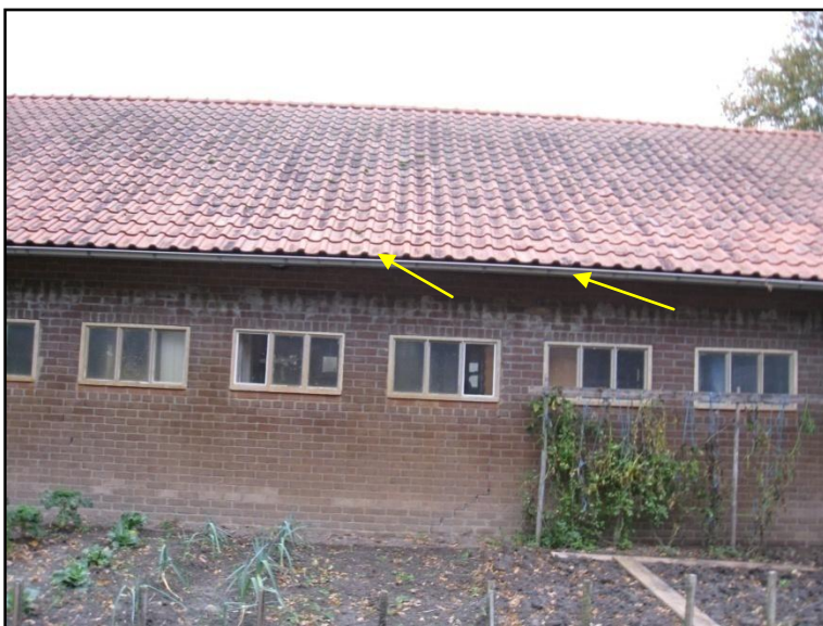
Figuur 12. Geschikte toegangsmogelijkheden onder de dakpannen voor huismus.
