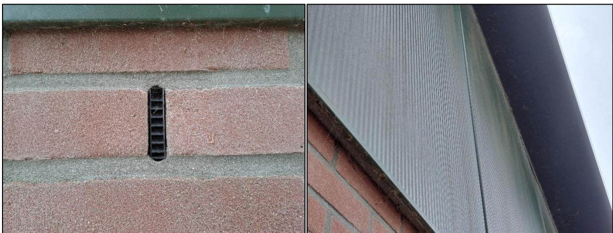
Foto links: niet toegankelijke open stootvoeg in gevel. Foto rechts toont een deel van de kopgevel van de stal waarbij dak overstek en gevelbekleding nauw aansluiten.
