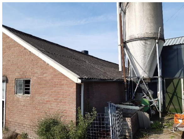
Foto 6: Stal met asbestverdachte dakbedekking, gezien vanaf de Haarweg
