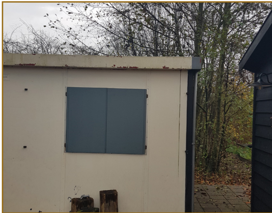
Afbeelding 16: Tijdelijke schaftvoorziening. Geen openingen aanwezig.
