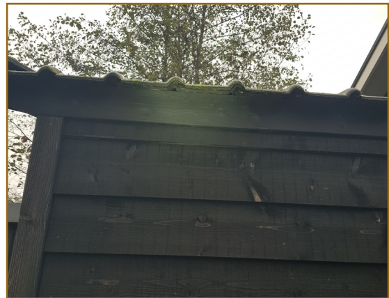
Afbeelding 13: Tijdelijke woonunit. Geen openingen onder dakbedekking aanwezig.
