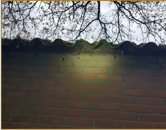
Afbeelding 10: Kalverenstal openingen onder golfplaten, dicht door hout.
